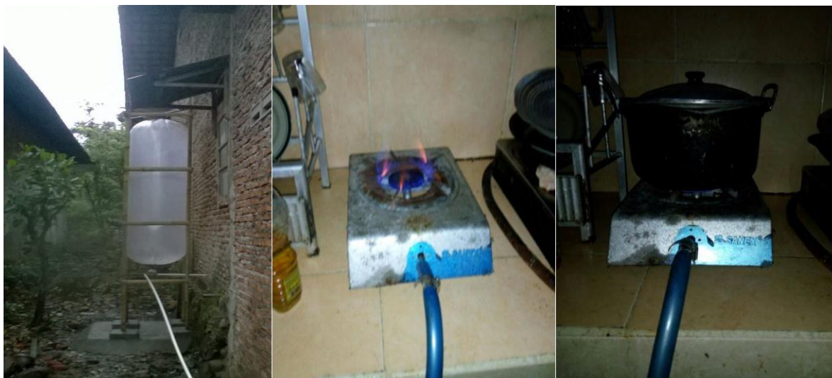
Gambar 5. Penampung biogas dan kompor biogas
